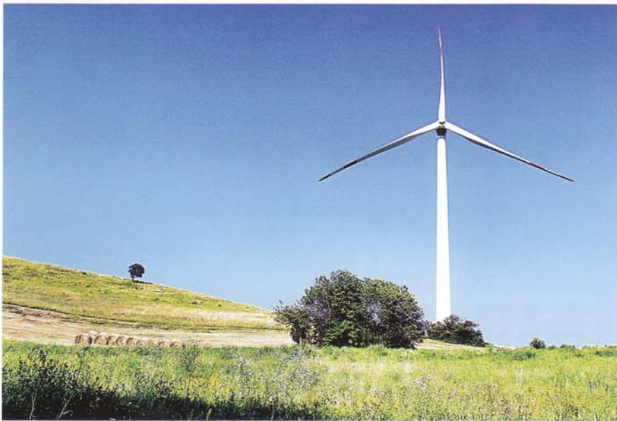
Pala eolica a Badia Calavena
